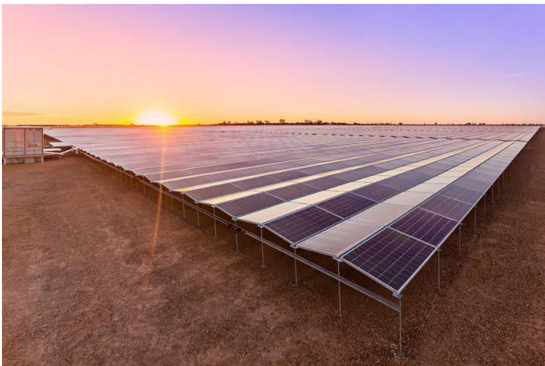
Fotografia 7 Przykład elektrowni realizowanej w układzie wschód-zachód. Brak możliwości rolnego wykorzystania terenu pod panelami. (źródło: https://belectric.com/solarplants/peg/ dostęp z 8.10.2019)
