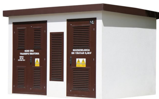
Fotografia 2 Przykładowa kontenerowa stacja elektroenergetyczna (źródło: http://zpue.pl )
