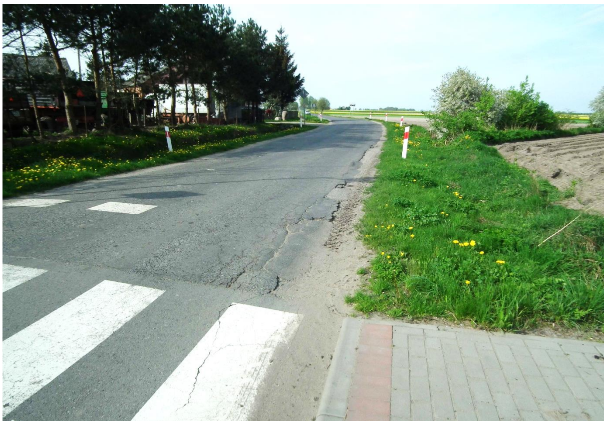
Fot. 2.3. Fragment drogi do wymiany nawierzchni i poszerzenia poboczy.
