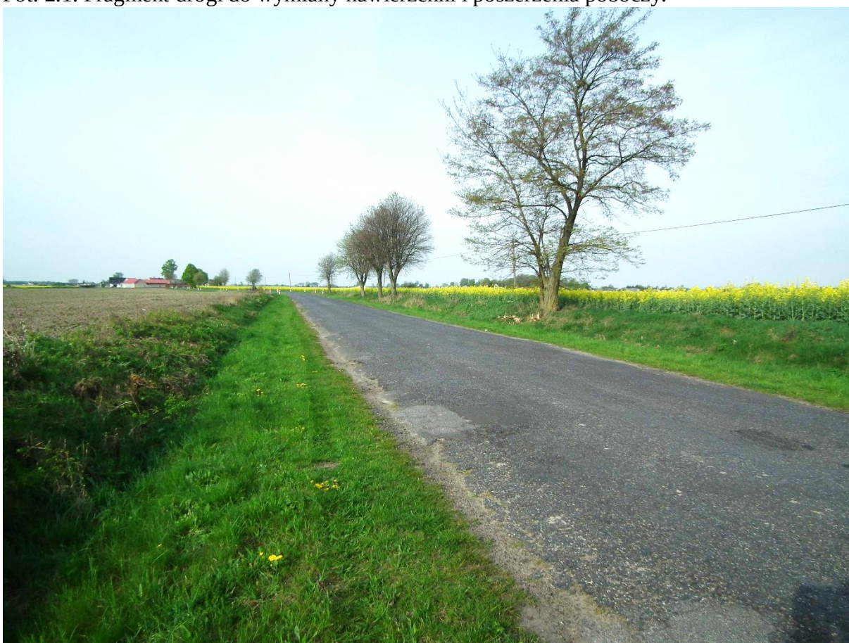
Fot. 2.2. Fragment drogi do wymiany nawierzchni i poszerzenia poboczy.
