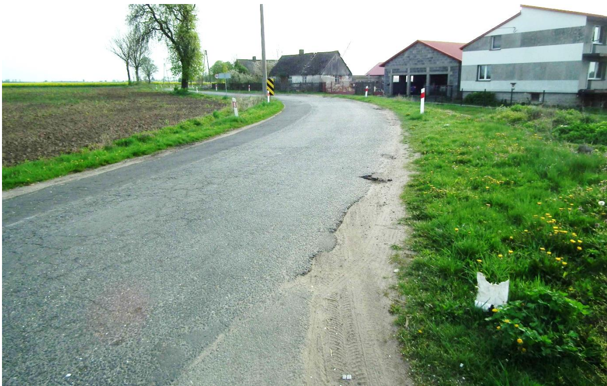
Fot. 2.1. Fragment drogi do wymiany nawierzchni i poszerzenia poboczy.
