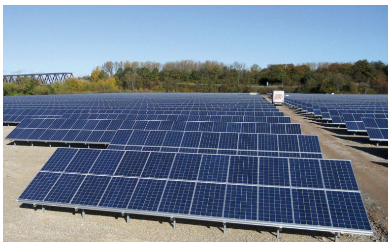
Fotografia 4 Elektrownia fotowoltaiczna w Iffezheim (źródło: http://www.wuerth-solar.de/solar/de/wuerth_solar_2012/unternehmen_1/referenzen_4/referenzen_12/referenzen.php 05.11.2012)
