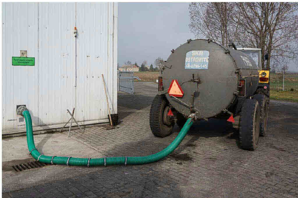
Fot 3 Punkt zlewny – zrzut ścieków
