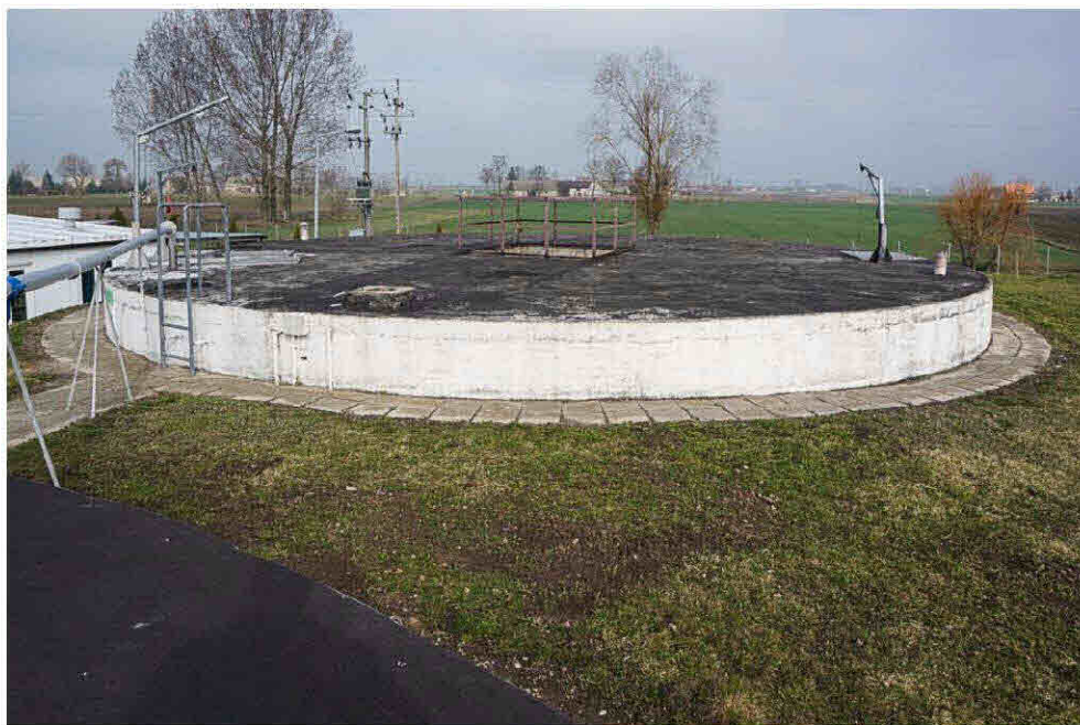
Fot 8 Reaktor sekwencyjny SBR 2 (aktualnie zbiornik retencyjny ścieków)
