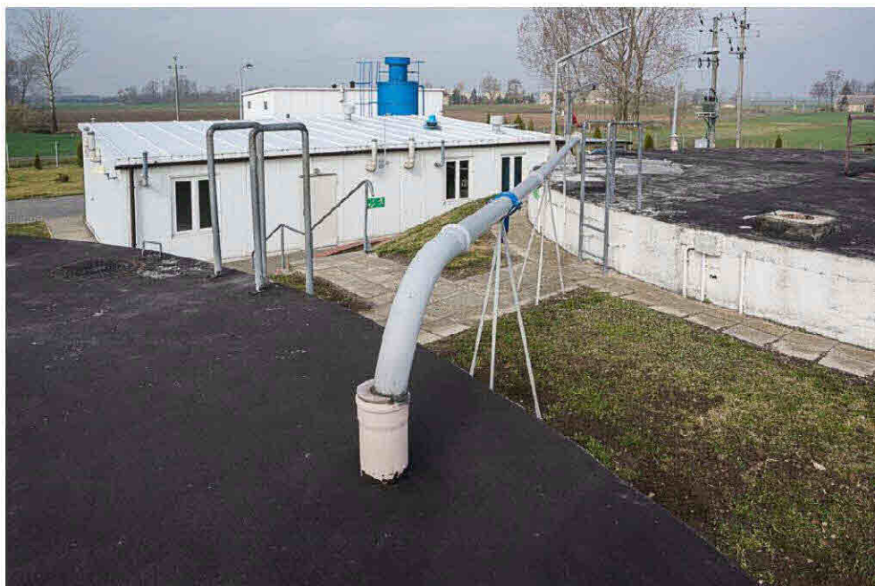
Fot 1 Tymczasowe połączenie reaktorów SBR 1 i SBR 2
