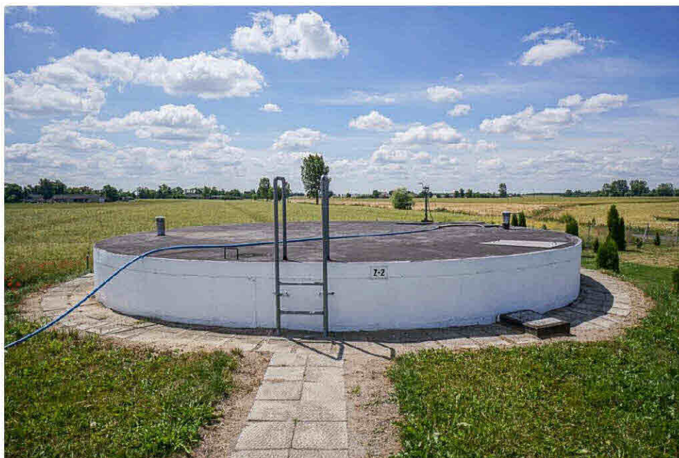
Fot 10 Grawitacyjny zagęszczacz osadu
