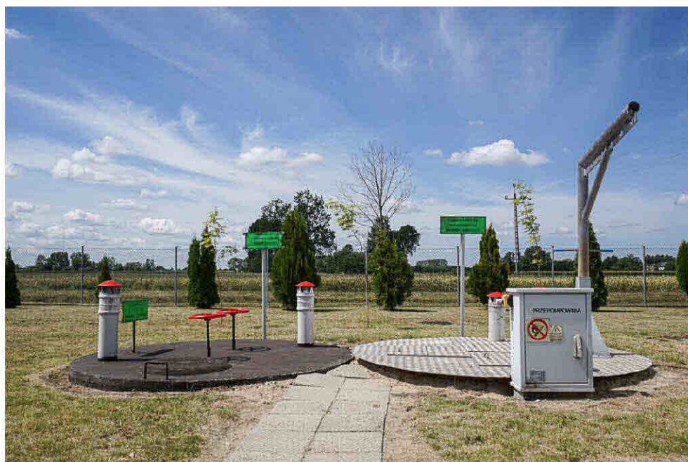
Fot 5 Pompownia główna
